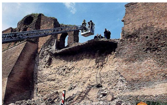
Tratto fra le torri 7 e 8 dopo la caduta del paramento
