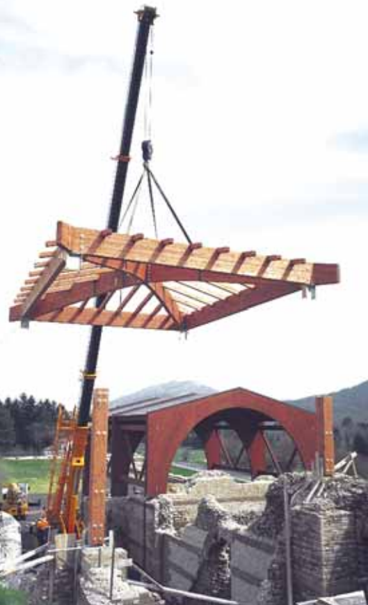
• Le nuove strutture durante alcune fasi del loro montaggio (foto V. Fasolo 2005)
